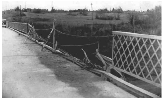
Ce qu'il restait du garde-fou du pont
