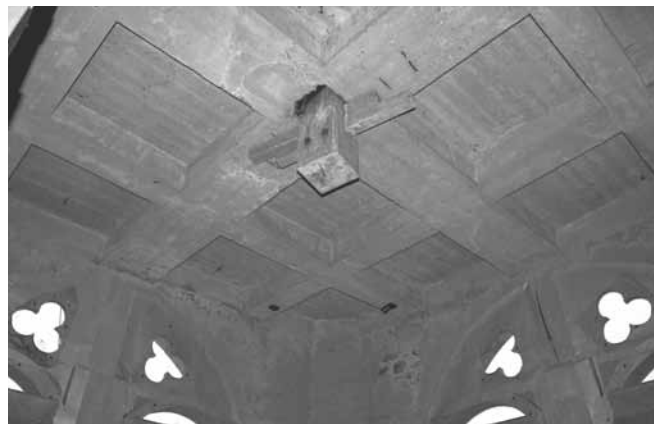
La chambre des cloches est scellée par un plafond de béton armé. La partie inférieure de la longue poutre centrale de la flèche y est retenue par de solides tenons de bois
