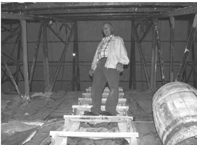
Employé occasionnel de la Fabrique, Léopold Corriveau se tient dans un escalier rudimentaire entre le toit et la voûte de la nef. On distingue un tonneau ayant servi à mélanger du plâtre.
