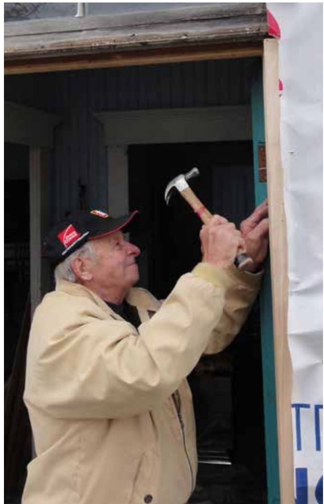
Fort de ses 86 ans, monsieur Georges Nadeau a tenu à fournir sa collaboration bénévole pour aider à restaurer l'ancienne école du rang Nord-Est. Il n'a rien perdu de son habileté, de sa rapidité, ni de sa belle humeur lorsqu'il répare la porte d'entrée.
